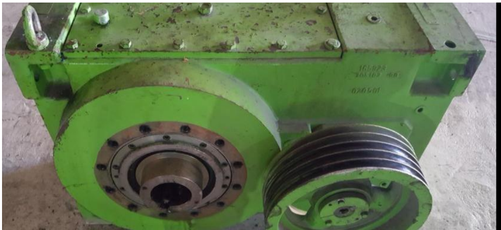
Figura 11.3. Revisión de desgaste en reductor de la máquina peletizadoras está en buen estado para seguir trabajado adecuadamente.
