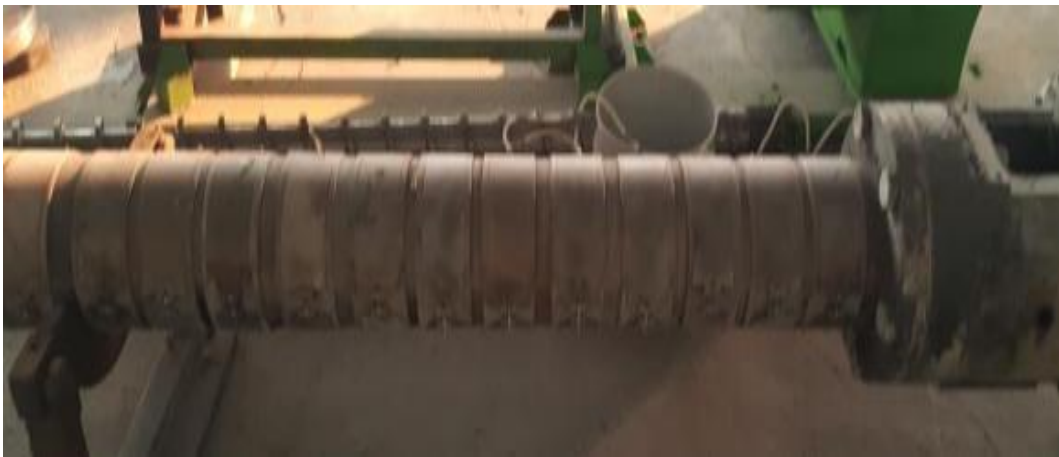
Figura 11.14. Resistencias térmicas en mal estado.
